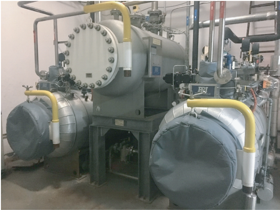
图 4 污水处理设备
